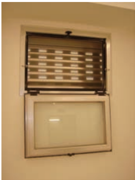
Figura 13: Janela para eventual arejamento de um depósito de documentação, possuindo vidros duplos, estando integrada numa abertura de pequenas dimensões, onde foi colocada uma grelha de sombreamento com uma rede mosquiteira. Entre esta grelha e a janela, existe uma caixa de ar, por forma a reduzir o impacto das oscilações do ambiente externo.
