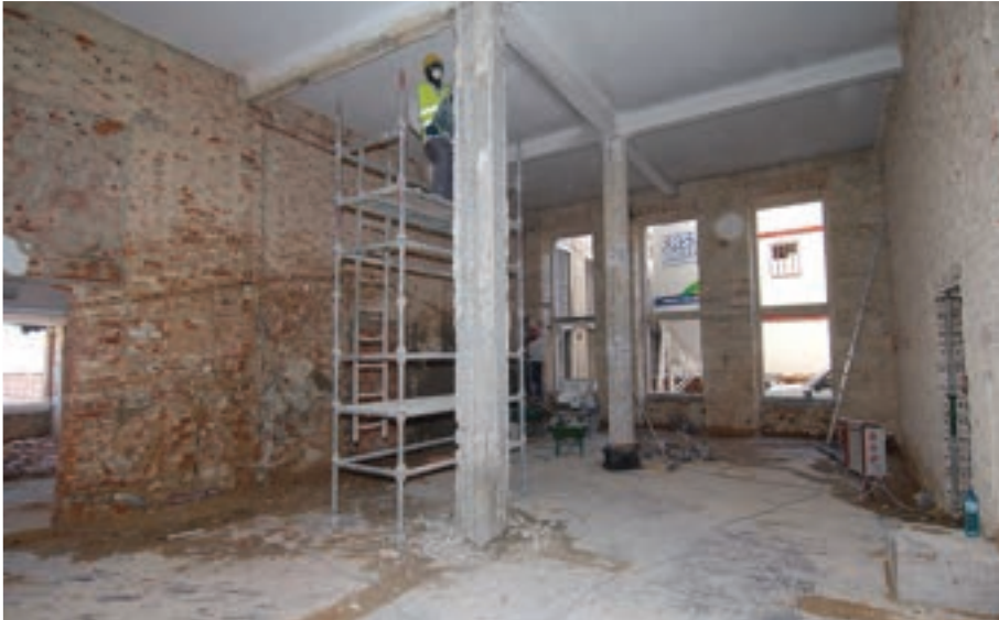
Figura 14: No caso do Arquivo Histórico da Misericórdia de Lisboa, uma vez que o pé direito do piso possuía uma altura suficiente para instalar um andar intermédio, optou-se por efetuar este aproveitamento, que acabou por potenciar o espaço disponível para depósitos de documentação.
