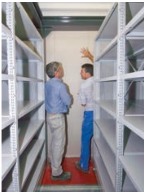
Figura 17: Instalação de placas de gesso laminado numa das paredes dum depósito, sendo que estes elementos têm por objetivo garantirem uma maior estabilização dos valores da humidade relativa em cada um destes espaços.
