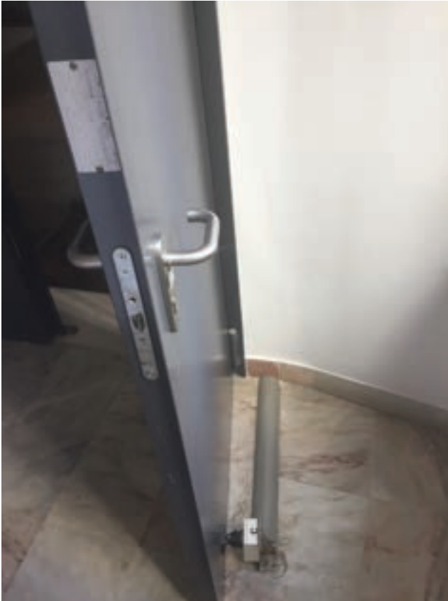
Figura 16: Eletroiman instalado numa porta corta-fogo.
