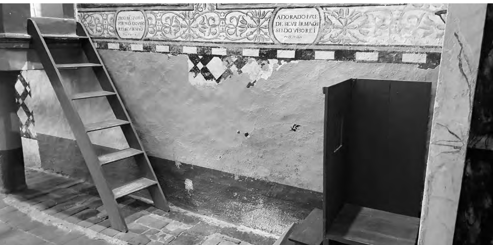
Estado da pintura mural antes da obra.
