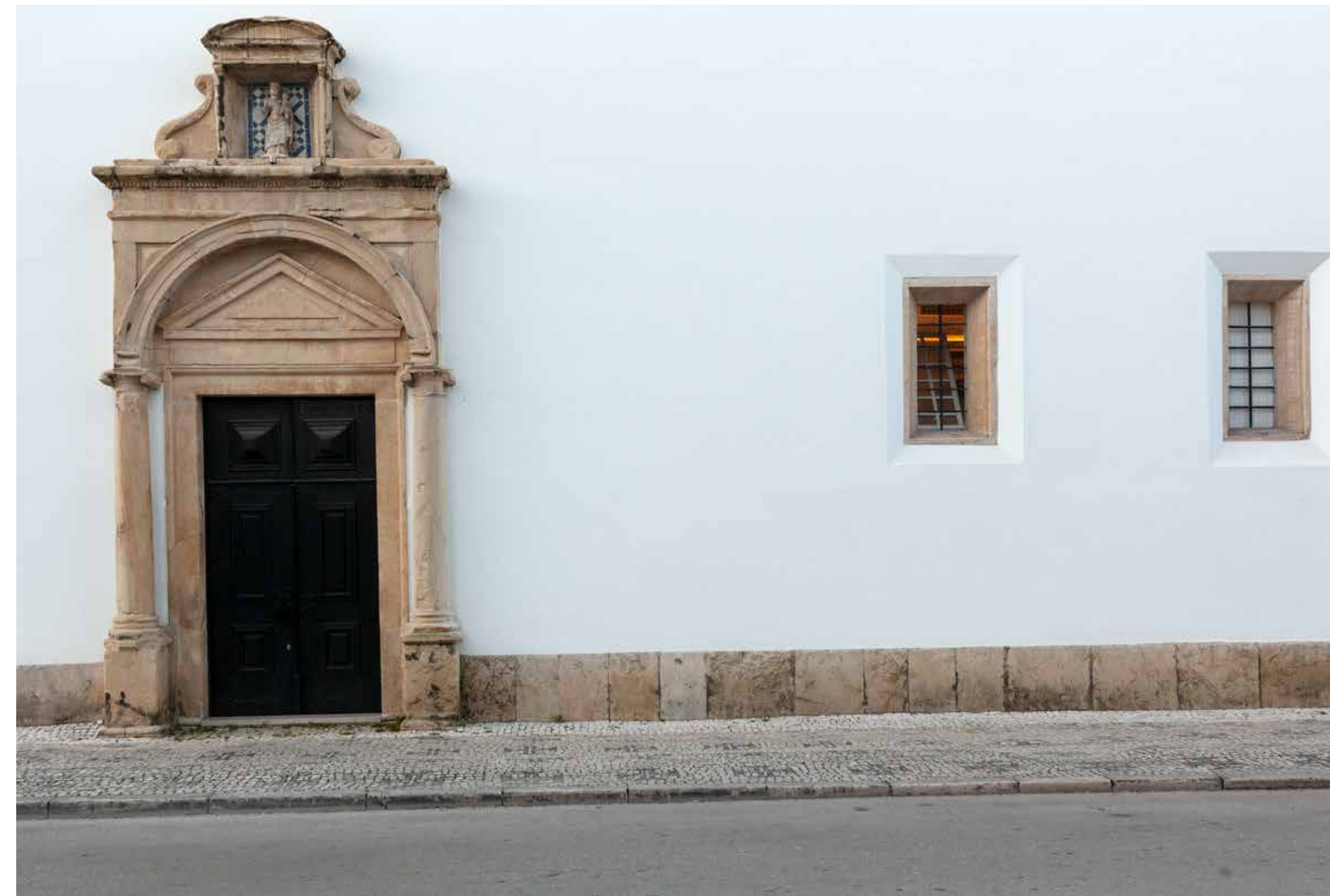
Picados os rebocos, apareceu a evidência de quatro janelas que estavam entaipadas, ainda com as grades e cantarias primitivas. Optou-se pela sua abertura que trás luz, combate a humidade interior e recupera a traça da fachada exterior.
