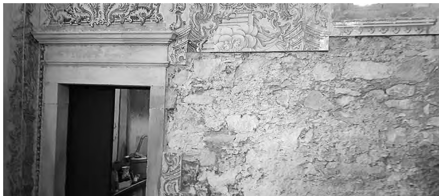
Antes, durante e depois da obra apoiada pelo Fundo. Só foi possível recuperar os painéis de azulejos porque a Misericórdia foi guardando cada peça à medida que se descolava da parede.
