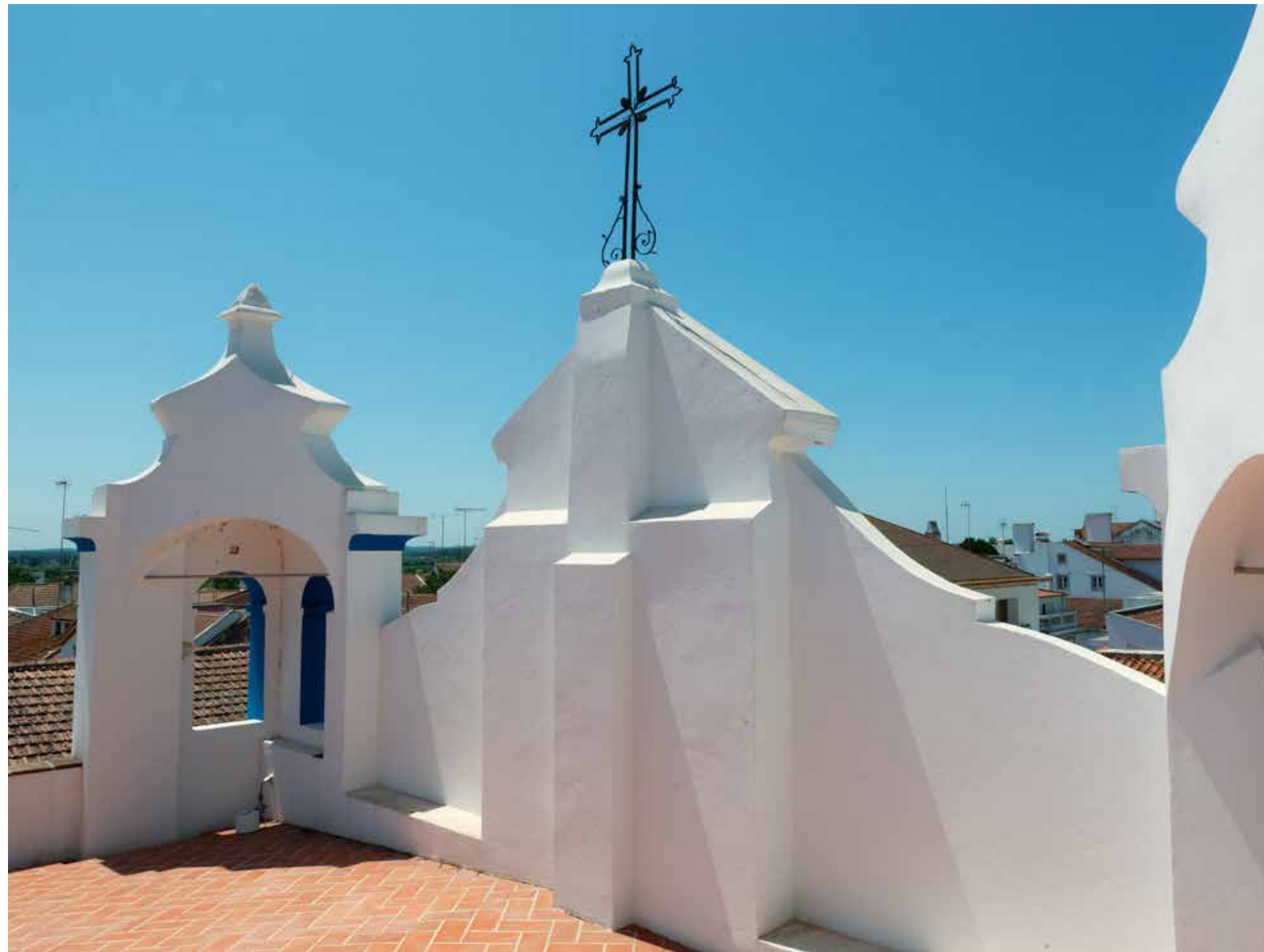
A obra na Igreja da SCM de Coruche implicou uma consolidação total da cobertura que também protege as pinturas murais agora desvendadas no interior.
