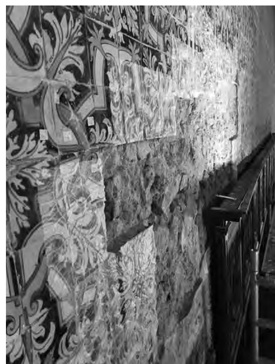
Havia azulejos com problemas de fixação na parede, perda de vidrado e risco de perda total junto ao cadeiral. Hoje estão restaurados e bem fixos.
